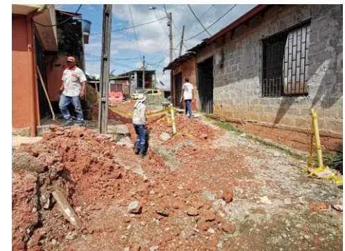
Identificación de usuarios en el barrio Minuto de Dios, a predios que requieren la instalación de acometidas para el servicio de acueducto.
