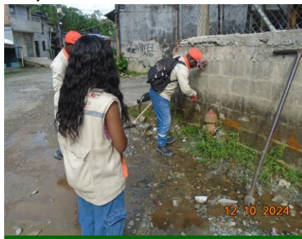
Apoyo a infraestructura en el retiro de hidrante ubicado en la parte baja del Minuto de Dios
